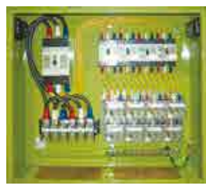
■動力分電盤 型式 KM2064N-E
